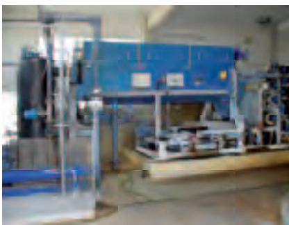
Die Siebbandpresse hat bald ausgedient. Sie wird durch eine moderne Zentrifuge ersetzt.
