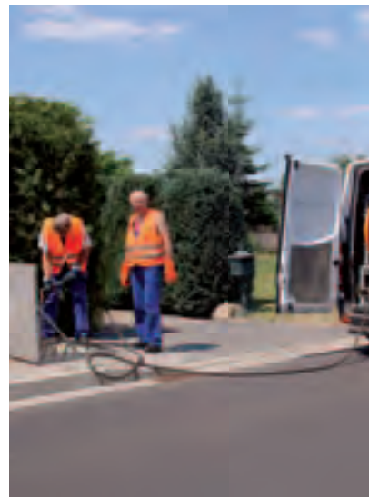
Das Service-Team der NUWAB war in diesem Sommer häufig mit den Hochdruck-Spülfahrzeugen im Einsatz, um Kanäle und Pumpstationen zu reinigen.
