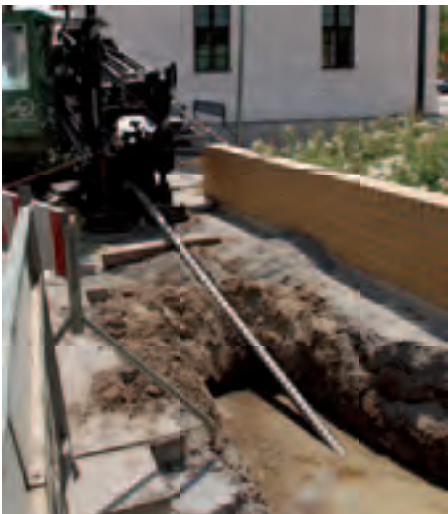
Mittels des gesteuerten Horizontalbohrverfahrens wurden die Bundesstraße 101 und die Nuthe in bis zu sechs Meter Tiefe unterquert.
