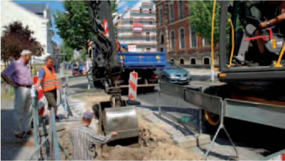
An den Enden der Querung in Höhe der Feuerwehr und der Poststraße in Luckenwalde wurden bei den Unterführungsarbeiten lediglich eine Start- und Zielgrube ausgehoben.
